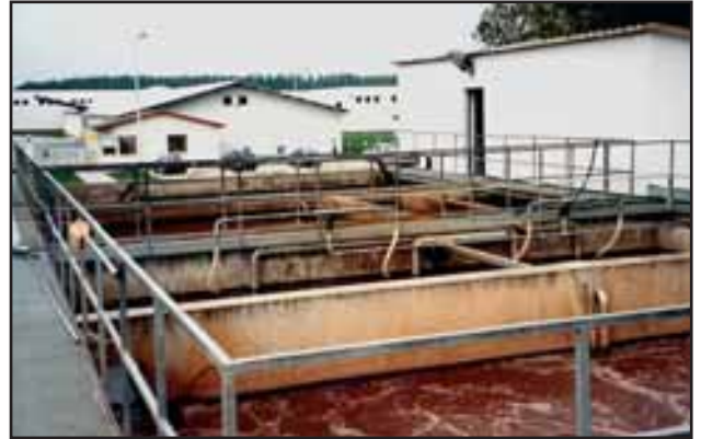
Abwasserentsorgung der Firma HIPP - Nahrungsmittelherstellung in Hansagliget (Ungarn), 4.200 EGW
