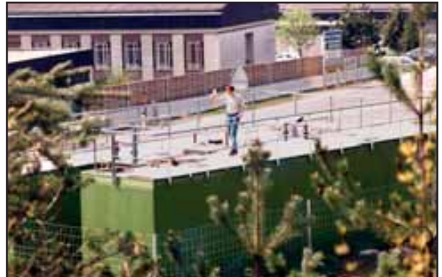
Abwasserentsorgung der Autobahnraststätte Alland, 800EGW nunmehr verlagert in die Gemeinde Traunstein, mit Denitrifikation
